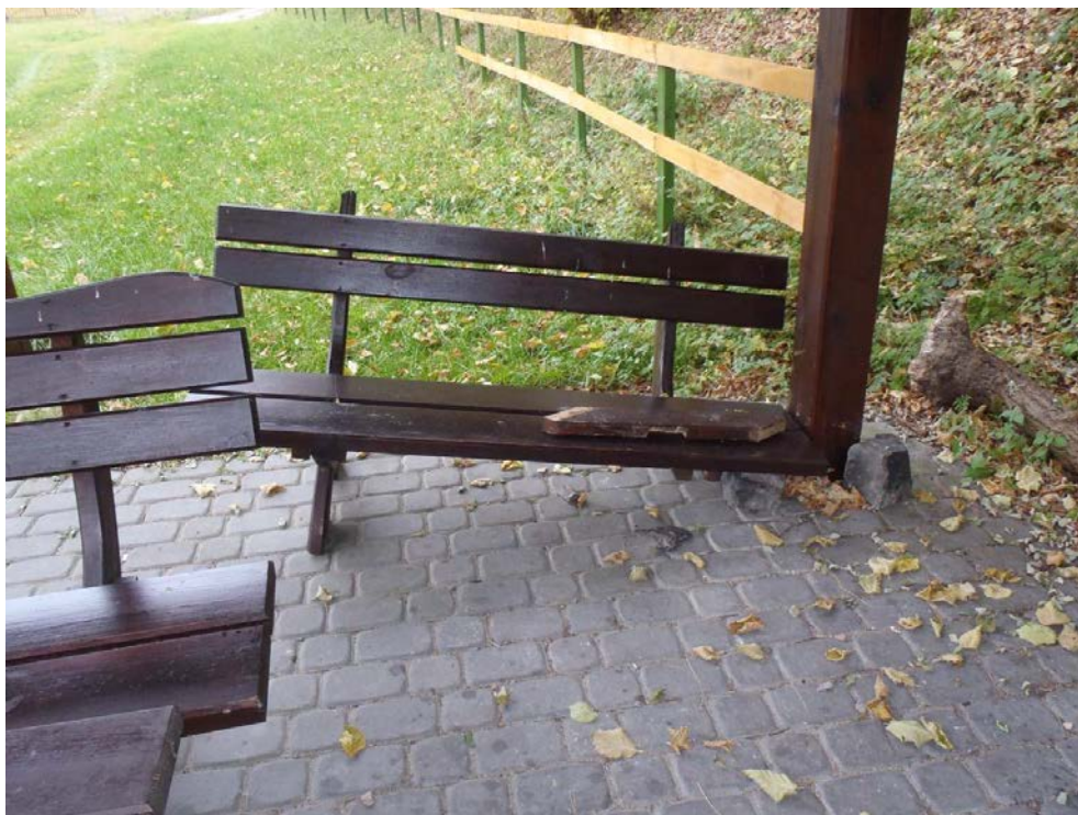
Fot. 15. Dewastacja elementów infrastruktury szlaku kajakowego (Wda)
