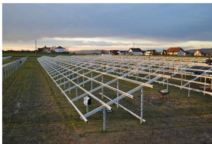
Fot. 5. Konstrukcje wsporcze ogniw fotowoltaicznych
