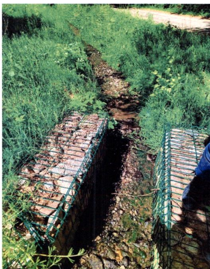
Zdjęcie nr 15. Rów, do którego odprowadzane są ścieki oczyszczone
