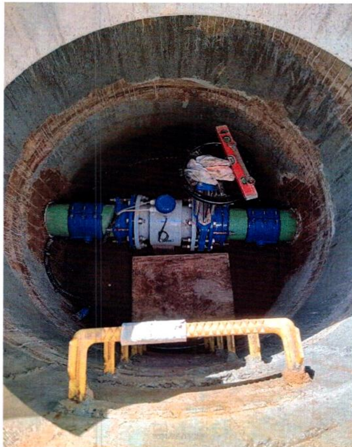
Zdjęcie nr 13. Wnętrze studzienki pomiarowo – zaworowej SPZ4
