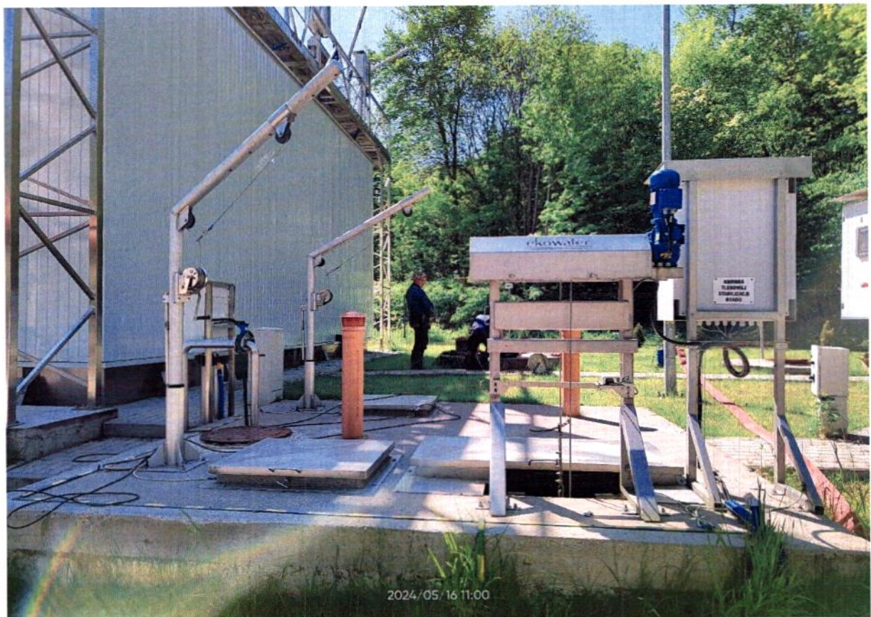
Zdjęcie nr 11. Komora tlenowej stabilizacji osadu
