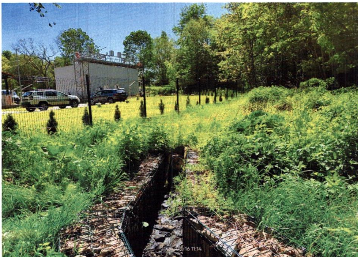
Zdjęcie nr 14. Wylot ścieków oczyszczonych
